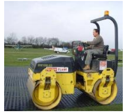
Nachdem 3-4 Reihen ausgelegt sind, werden sie bis auf die letzten Reihe eingewalzt
